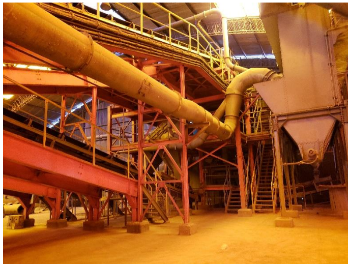
Figura 1.2.1-2 Sistema de alimentación del Horno Ausmelt
