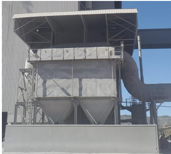
Figura 2.1.16-1 Las cuatro tolvas del sistema de filtros
