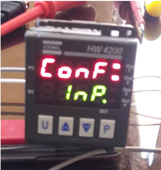
Fig. 2 CONTROLADOR DE TEMPERATURA
