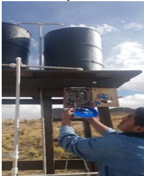
IMAGEN N° 35 Caja de Control Abierta
