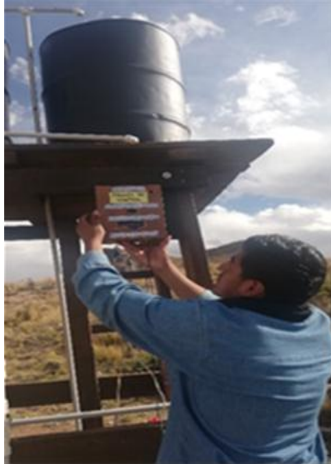
IMAGEN N° 34 Caja de Control
