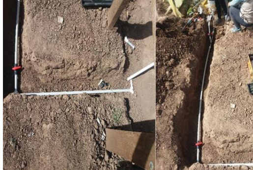
FOTOGRAFIA 10. Tubería principal de salida de agua
