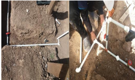
FOTOGRAFIA 34. Tubería secundaria y Sistema Venturi
