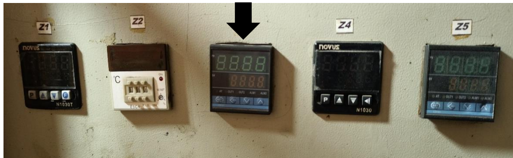
FIGURA N°25: Control de temperatura ya realizado el cambio
