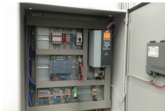
FIGURA N°4: Tablero de control
