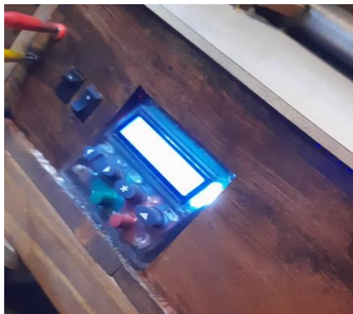
FIGURA N°25: Tablero de control
